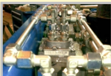
Distribuidores hidráulicos con válvulas de seguridad
